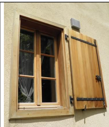
Exemple interdit de menuiserie en bois apparent. Le contrevent est fixé sur le cadre et non en feuillure
